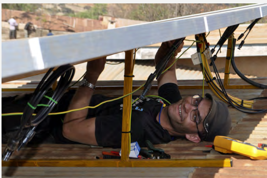
Tilkobling av solcellepanelene som er montert på taket. Skyggen under er en kjærkommen avkjøling på en varm dag.
